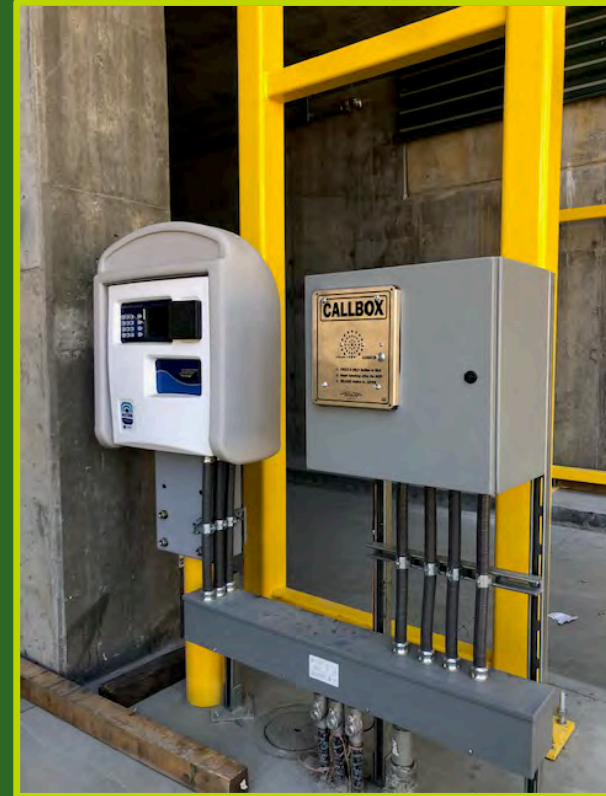
Loadout Kiosk/ Intercom
